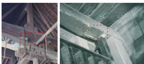
图3 中国古建筑木结构构件断裂
